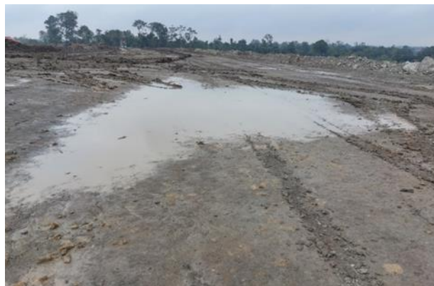
Gambar 1. Kondisi aktual badan jalan tergenang air
