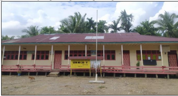
Gambar 1. Kondisi bangunan bentuk panggung SD Negeri 39 Tungkal I
