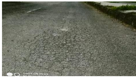
(1) Kerusakan Retak Kulit Buaya
