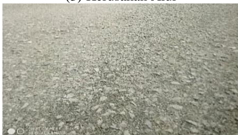
(5) Kerusakan Pelepasan Butir
